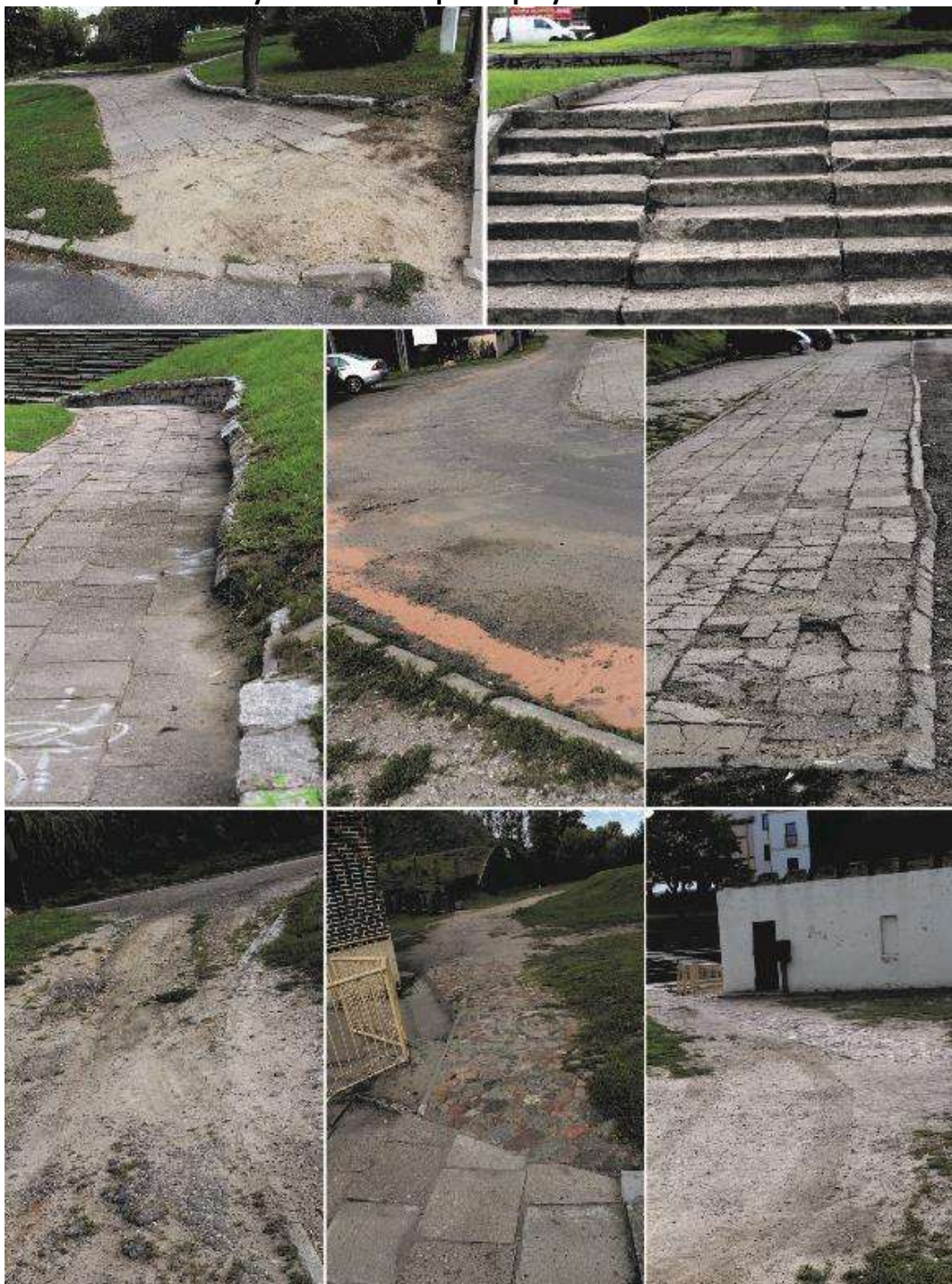
Fot. 3. Problemy techniczne w parku przy amfiteatrze i ul. Podzamcze
